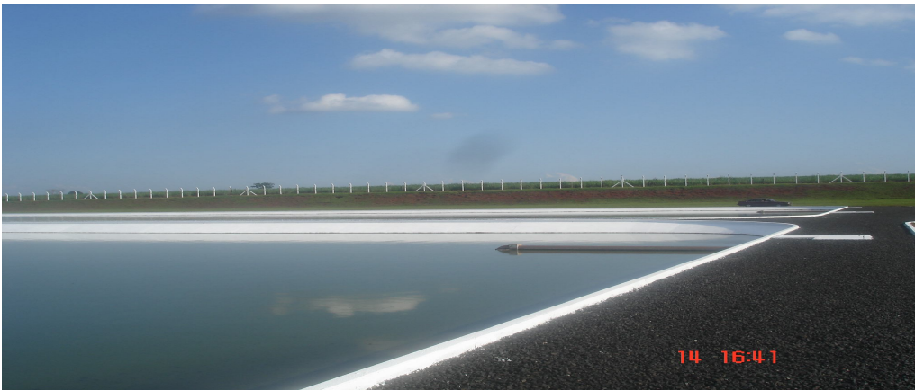
Lagoa de tratamento
